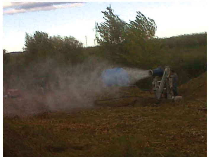
Impianto di abbattimento polveri a mezzo "cannoncini nebulizzatori"
